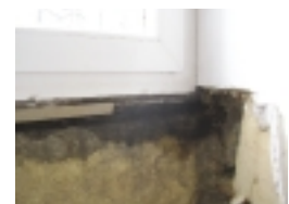
Photo 6 Infiltration d'eau consécutive à un montage défectueux d'une fenêtre réhabilitation
