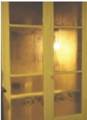
Photo 2 Condensation sur vitrage (pièce chauffée avec un appareil non raccordé à pétrole)
