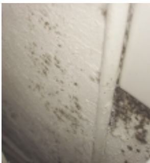
Photo 3 Développement de moisissures
