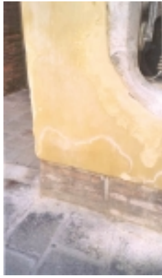
Photo 5 Efflorescences sur enduit
